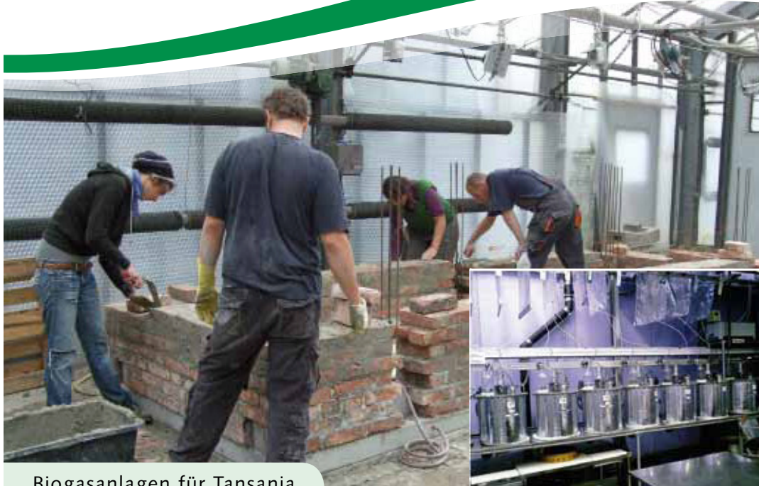
Biogasanlagen für Tansania
